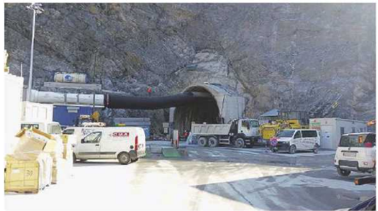
Nel cantiere I poliziotti della Digos all'interno dell'area dei lavori a Cravasco
