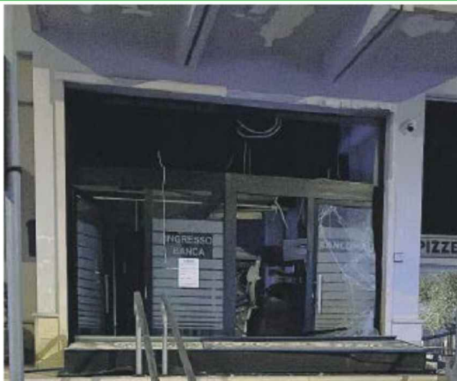
Una banda di malviventi ha fatto esplodere i due sportelli Atm utilizzando la tecnica della «marmotta»
