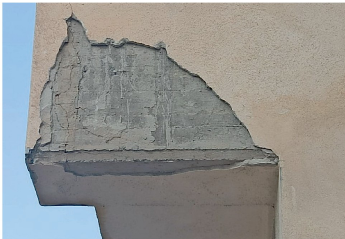
In alto l'ingresso del condominio di viale Moncada e due particolari relativi ai caduti da facciate e ballatoi
